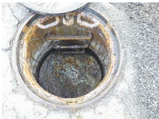
マンホール内湛水状況
