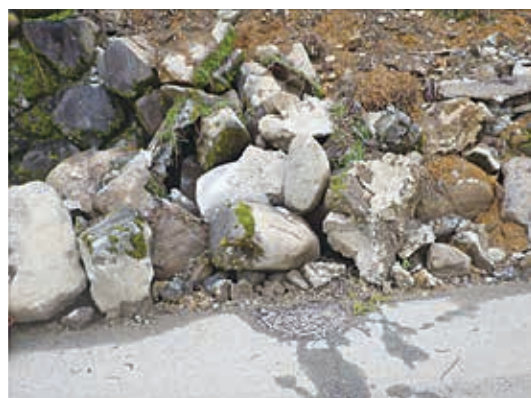
がけ崩れによりマンホール蓋開閉が不可
